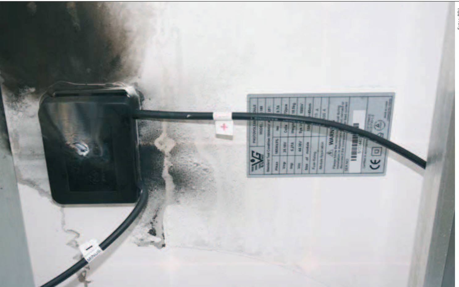
Vor solchen Schäden können Installateure ihre Kunden im ersten Jahr schützen, indem sie eine Allgefahrenversicherung ohne zusätzlichen Aufpreis für das erste Jahr direkt mitliefern.
